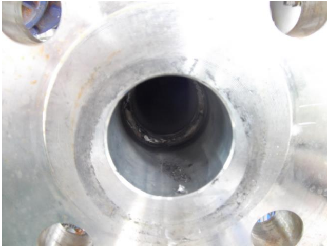
Späne in der Rohrleitung
